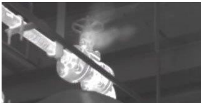
Figur 1 Eksempel på gasslekkasje fotografert med IR kamera
