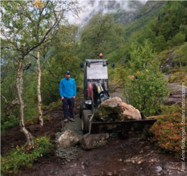
Manuell arbeidskraft og små maskiner er ofte best både til opparbeiding og vedlikehold.
